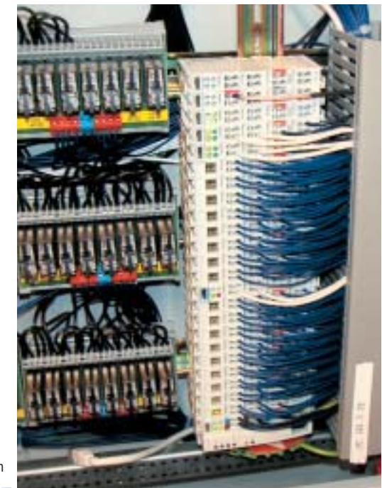
Schaltschrank mit WAGO- und EnOcean-Produkten
